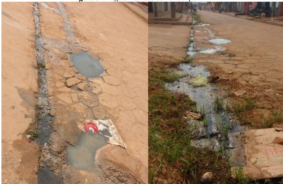
Figura 3 – Esgoto nas ruas de Buriticupu – MA
