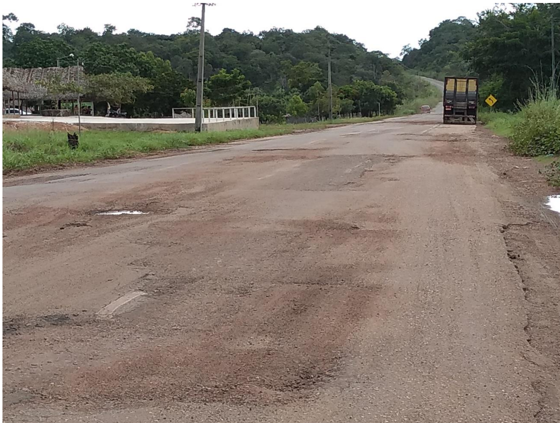
Figura 4 – Más condições asfálticas da BR 222 (município de Vargem Grande - MA)
