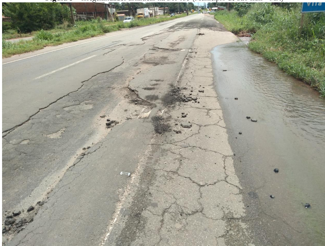
Figura 3 – Irregularidades asfálticas na BR-135 (Município de São Luís - MA)
